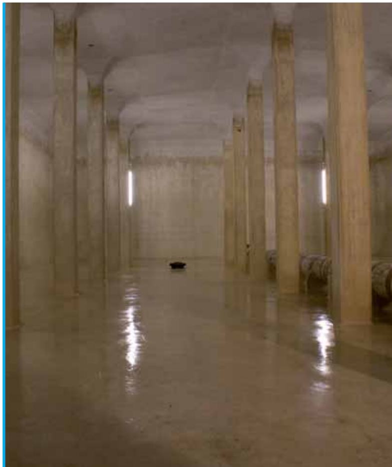
Резервоар за подпочвена питейна вода
